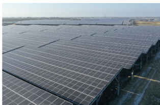
七股 120MW 漁電共生太陽能電廠
