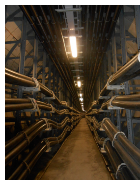
高港 ~ 高雄 345kV
